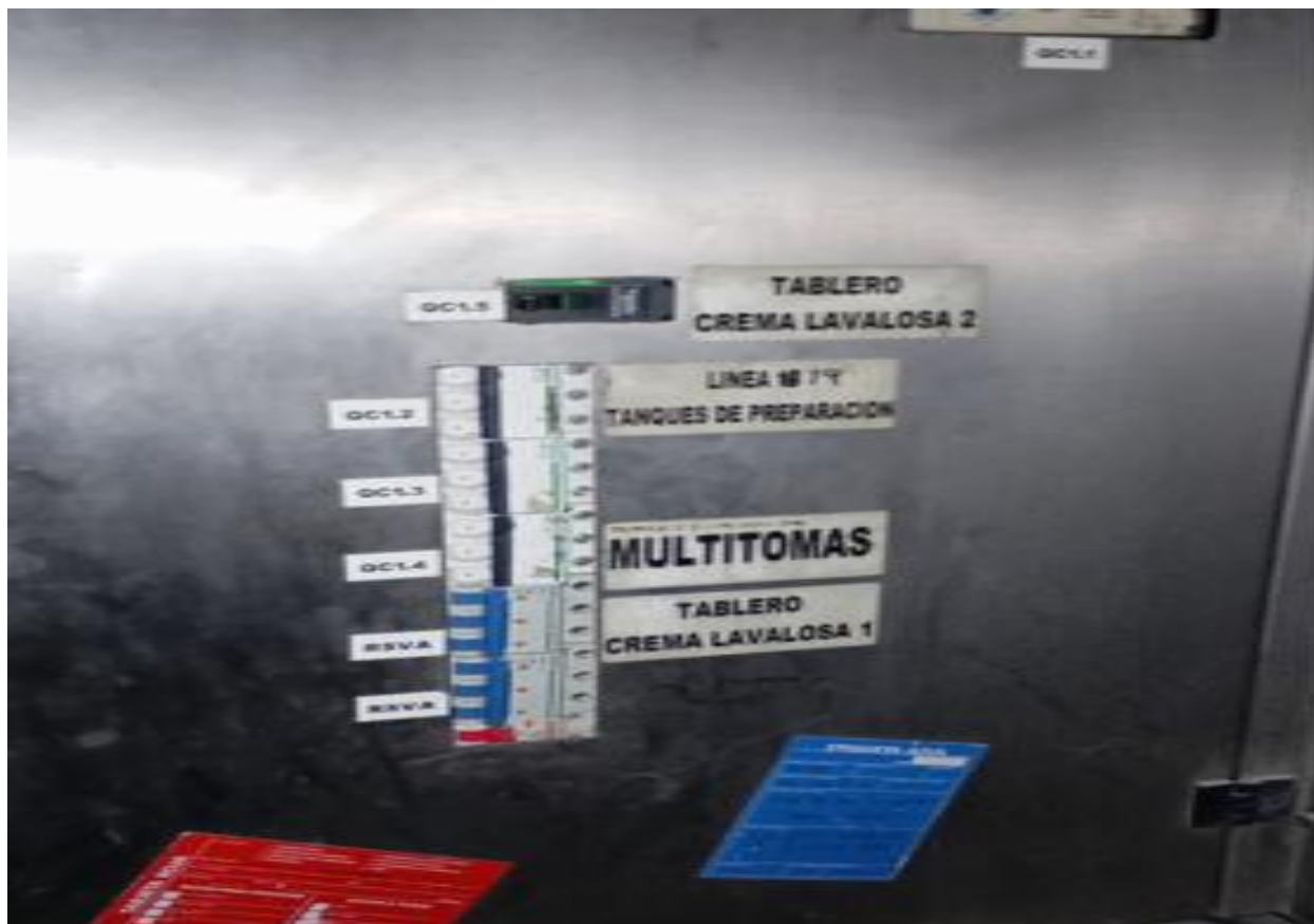
Ilustración 28. Tablero Eléctrico En Área De Crema Lava Loza. Elaboración Propia
