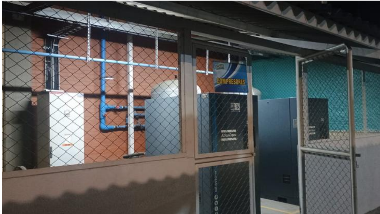
Ilustración 29. Cuarto De Compresores Berhlan De Colombia. Elaboración Propia
