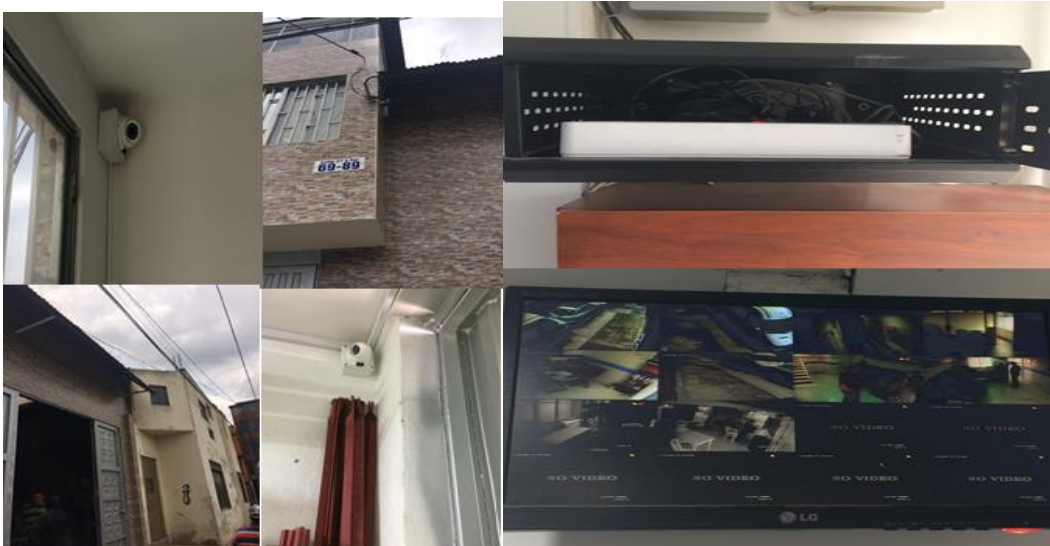
Figura 7. Elementos CCTV Fuente: Elaboración propia
