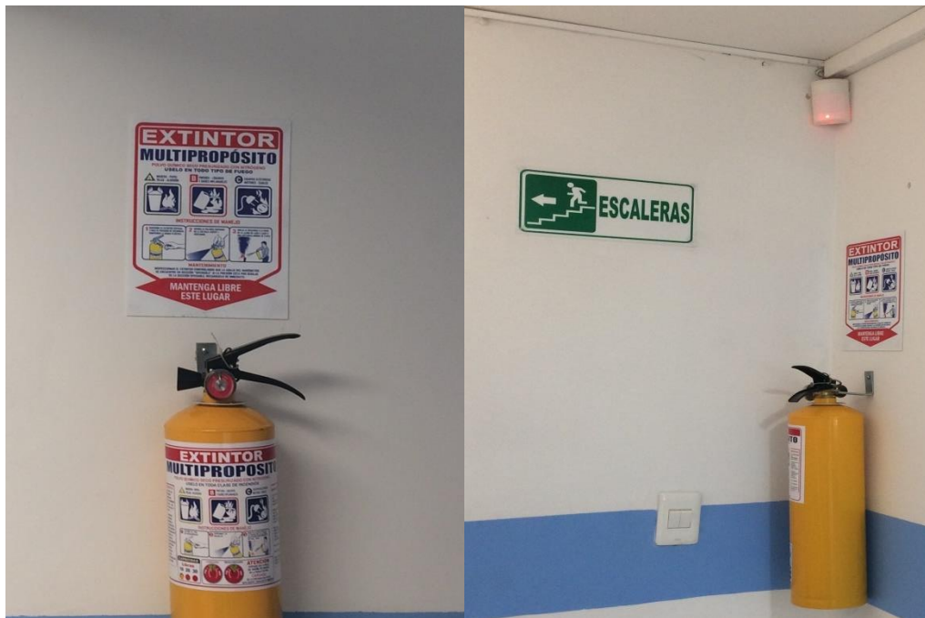
Figura 6. Vista extintores portátiles en plantas 1 y 2 Fuente: Elaboración propia
