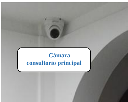
Ilustración 32 Cámara de Seguridad
