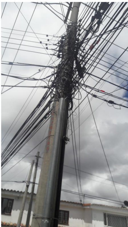
Ilustración 25 Cableado externo energía eléctrica
