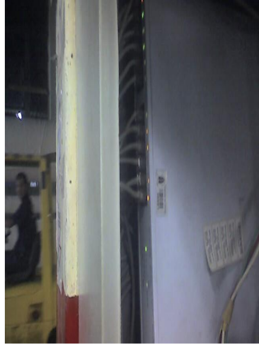
Figura 8. Red de datos y cableado sin escalabilidad ni crecimiento (D). Imagen tomada de un levantamiento en empresa del sector textil. Nombre reservado por solicitud del cliente.
