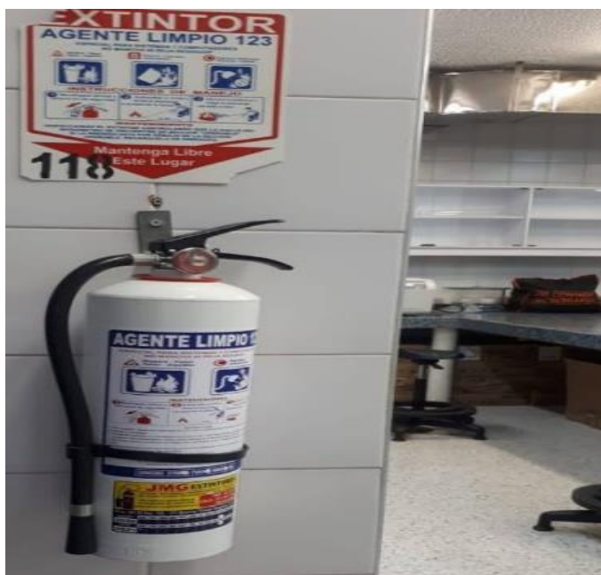
Figura 13 Extintor y Kit de derrames Fuente: Elaboración propia
