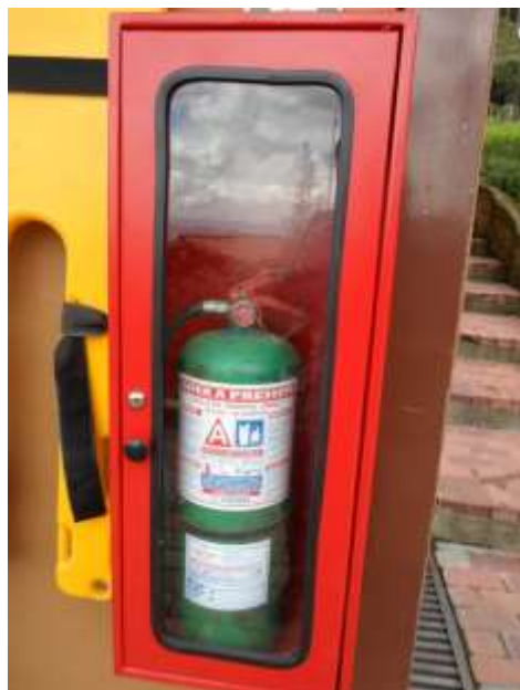
Foto 11: Extintor Bloque F
