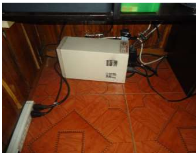
Foto 7: Conexiones de los equipos de cómputo
