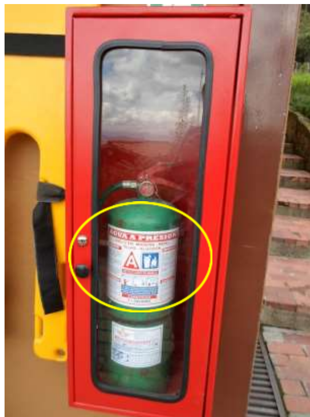
Foto 2: Extintor Bloque F
