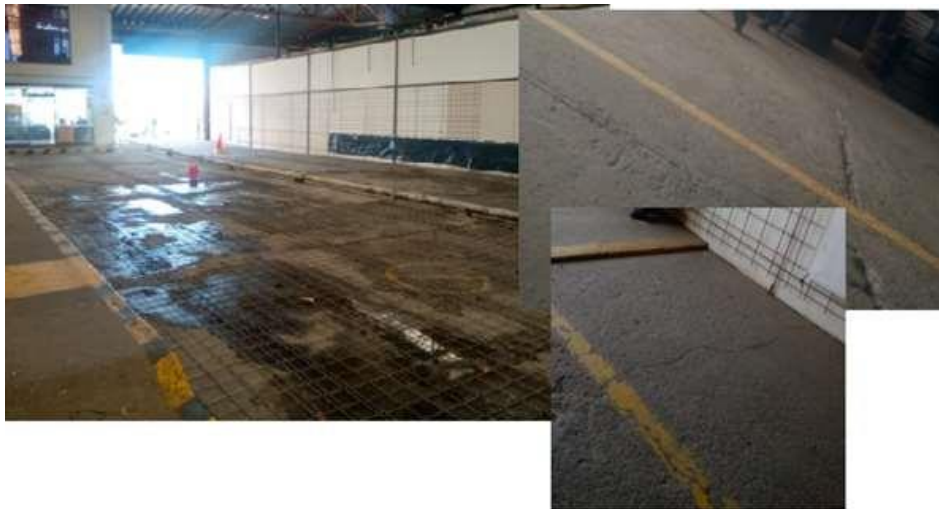
Figura 35 Estado de pisos en concreto
