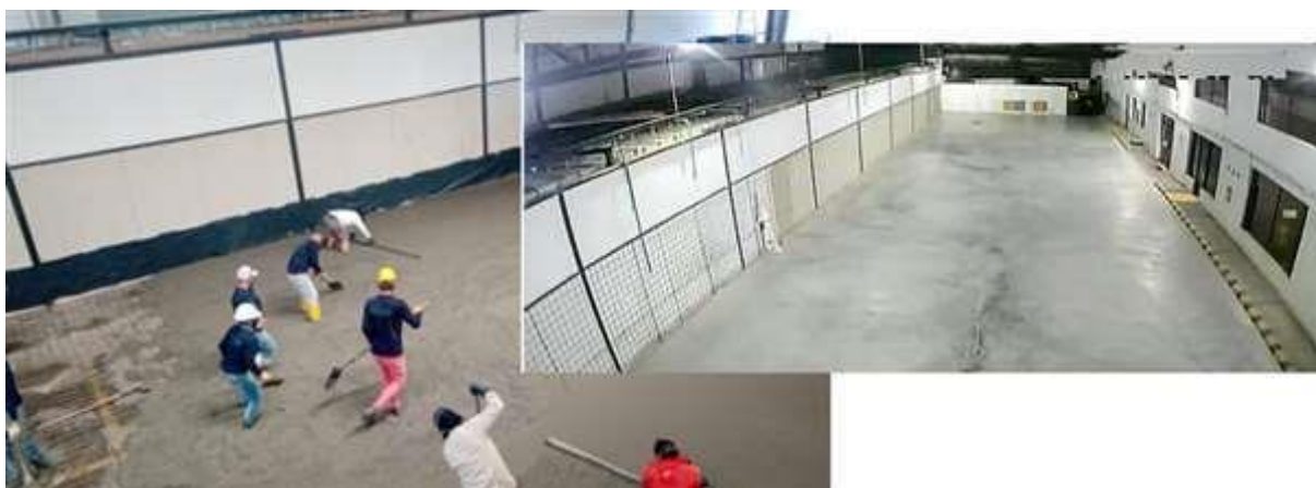
Figura 36 Estado del piso terminado con técnica de helicóptero.
