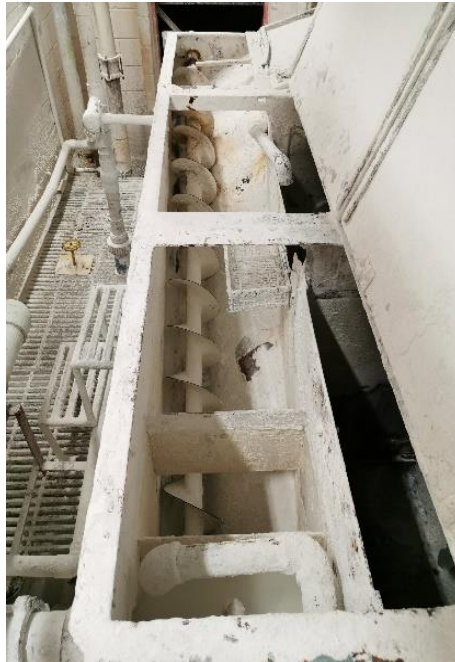
Ilustración 4.Extracción de los insolubles de cal mediante tornillo sin fin. Fuente: Propia
