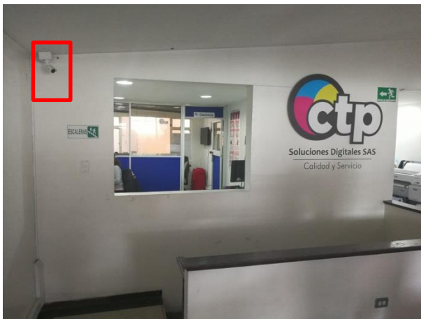
Figura 21 Cámara ingreso a las instalaciones
