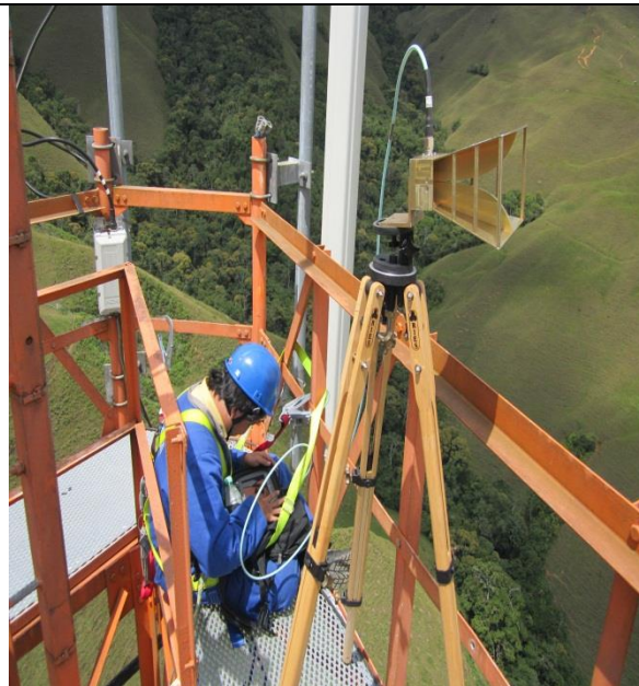
EQUIPOS DE MEDICIÓN EN TORRE
