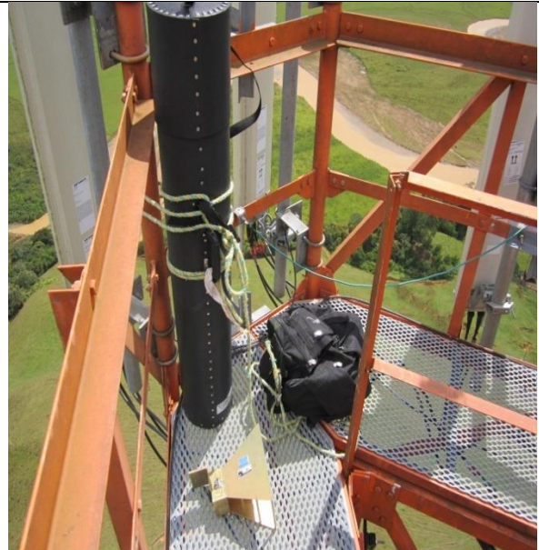
EQUIPOS DE MEDICIÓN EN TORRE
