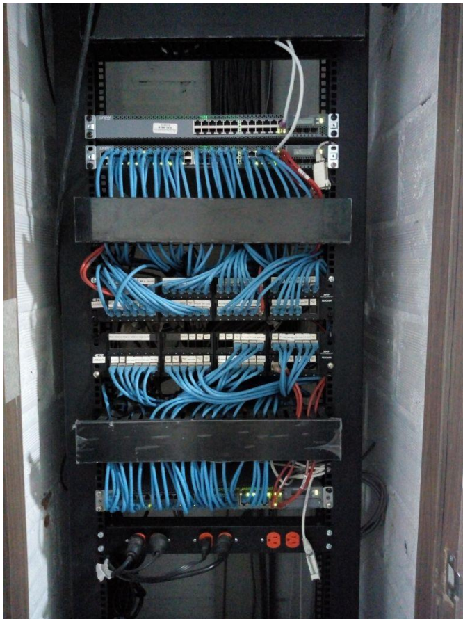
Figura 25 Rack Tercer piso (García, et al 2018) Institución Universitaria Politécnico Grancolombiano
