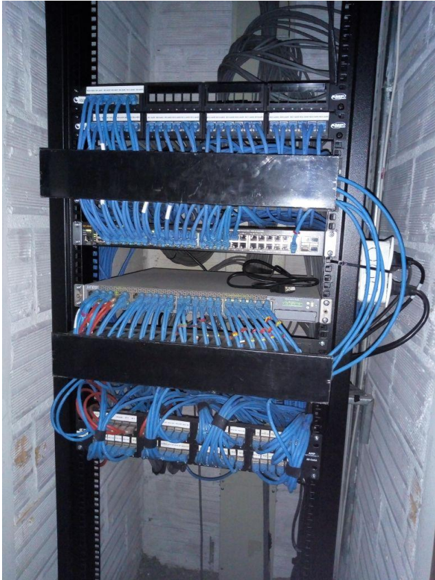
Figura 29 Rack Cuarto Piso (García, et al 2018) Institución Universitaria Politécnico Grancolombiano
