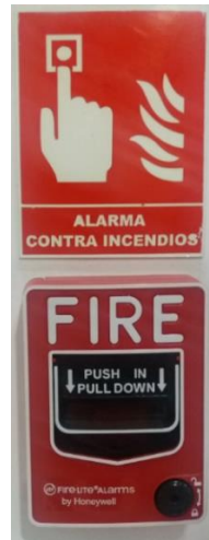
Figura 28. Alarma Contra Incendio 1
