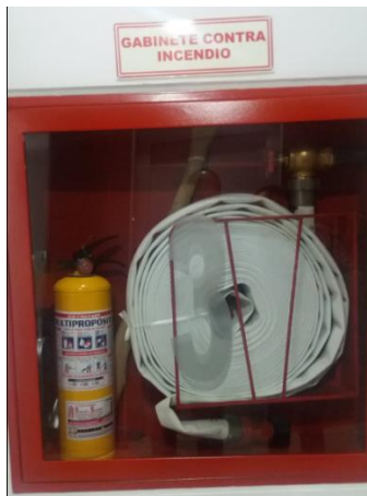
Figura 27. Red Contra Incendio 1
