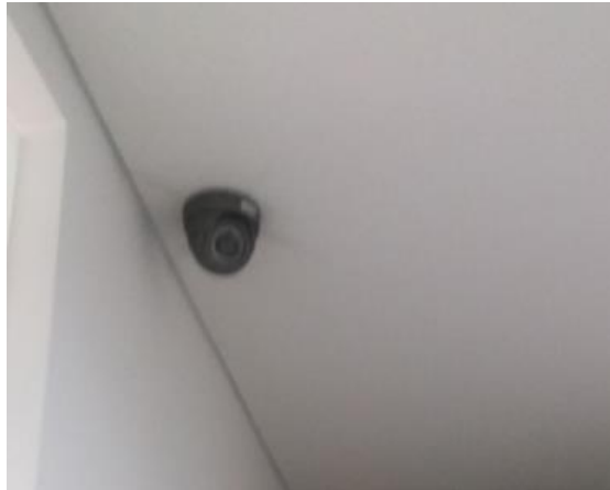
Figura 24. Cámara de Seguridad 1
