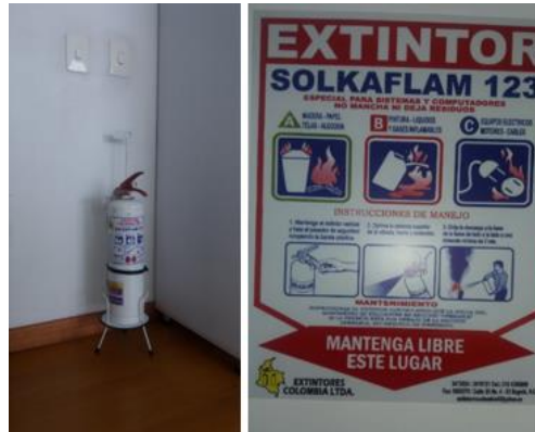
Figura 9. Extintor y Señalización 1
