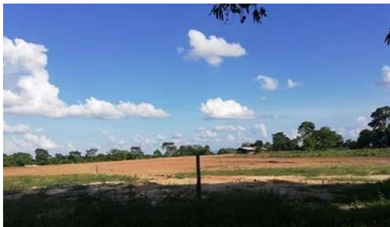
Figura 5. Terreno acondicionador para la siembra. Foto propia. Se puede observar que fue utilizada maquinaria pesada para el descapote y limpieza del terreno, dejándolo listo para el inicio del estaquillado y ahoyado.
