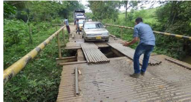
Figura 19. Puente en mal estado en la vía Tibú - Cúcuta. (Diario La Opinión, 2016)
